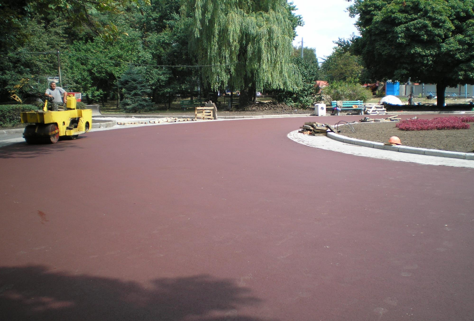
Покрытие из цветного асфальтобетона, устроенное в парке им. Горького г. Харьков (2006 г.)
