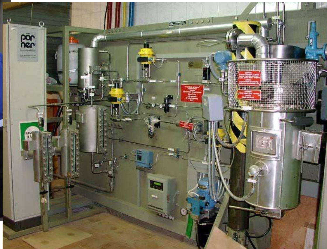
Пилотная установка “Битурокс”
